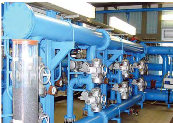
Leitungen und Armaturen im Wasserwerk (Filterablauf und Spülwasserverteilung)
