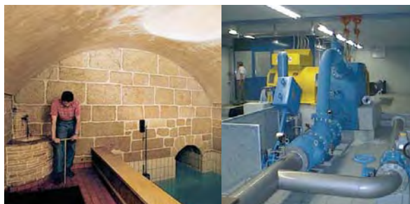
Brunnenstube und Turbine in einem Wasserwerk
