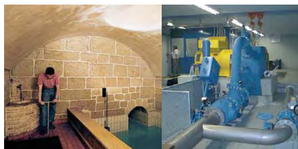
Brunnenstube und Turbine in einem Wasserwerk
