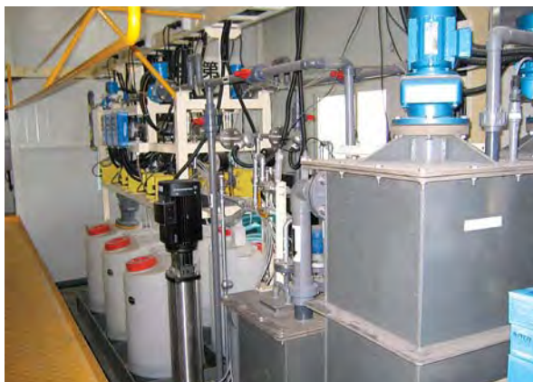
Teil der Pilotanlage im Klärwerk BeiXiaoHe
