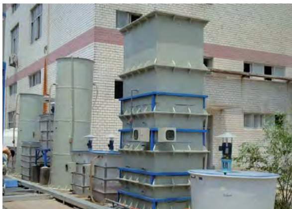
Eisenbett (Vordergrund), Zwischenklärung und Nachklärung (Hintergrund)
