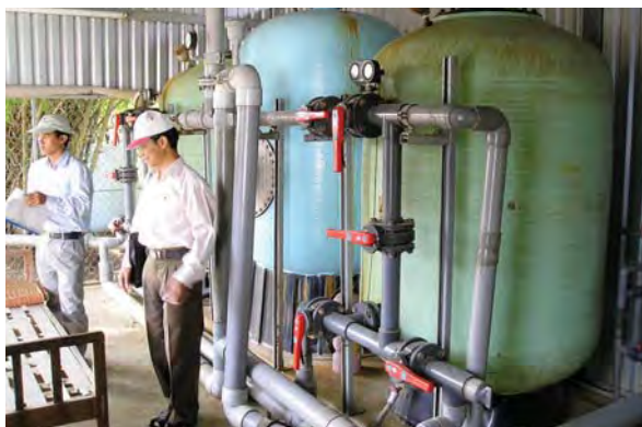
Anlage zur Trinkwasserversorgung
