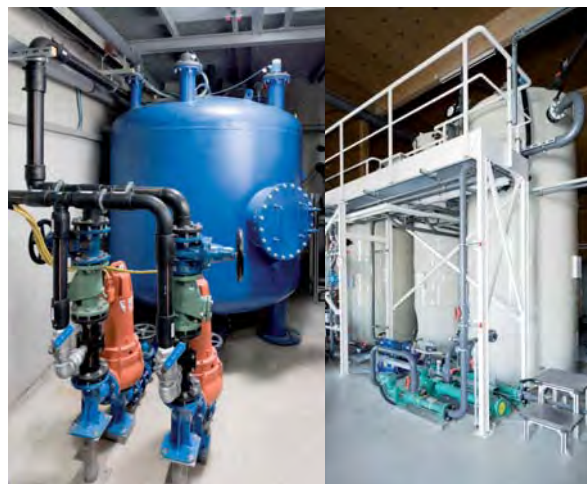
Eine Vakuumstation (links) und Bioreaktoren im Wasserhaus
