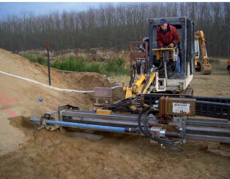
Mit marktüblicher Bohrtechnik sollen die linienförmigen Dränelemente in den Modelldeich eingebracht werden (Durchführung: Morath GmbH, Albbruck)
