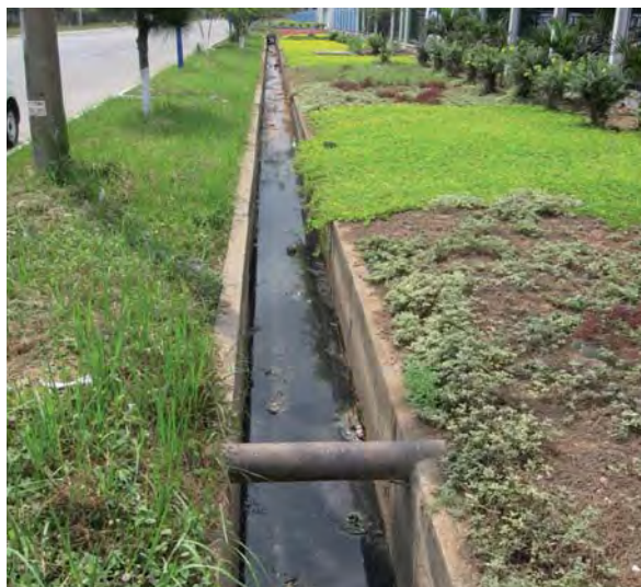
Ein Abwasserkanal in der Industriezone Tra Noc in Can Tho
